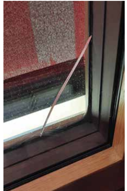
Grund für den Wechsel: Riss im Glas.
